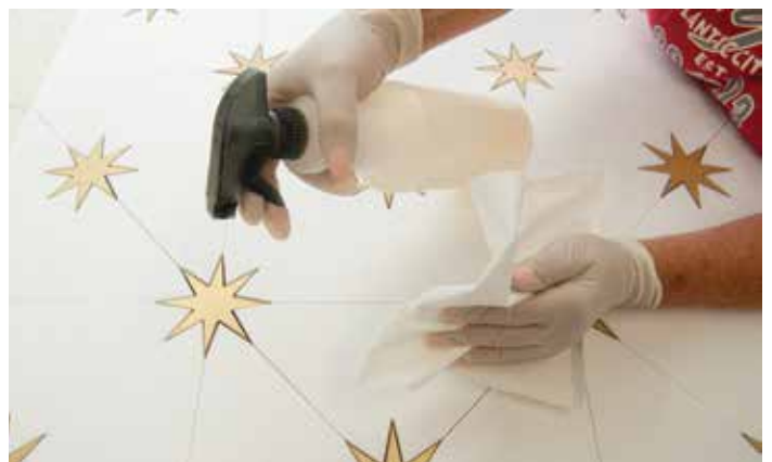
Pas 6 Appliquez un agent de scellement pénétrant alors que le coulis se libère, d'après les consignes du fabricant.
